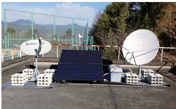
自立型防災通信ステーション
